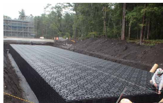
▲ 工場施設／普通車駐車場下設置
