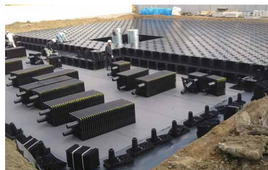
▲ スポーツ施設／テニスコート下設置
