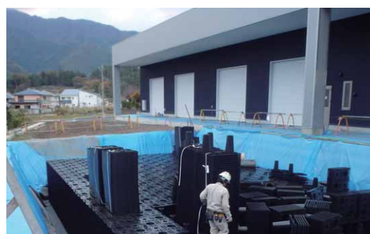
▲ 商業施設／普通車駐車場下設置
