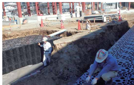
▲ 福祉施設／駐車場下・緑地下設置
